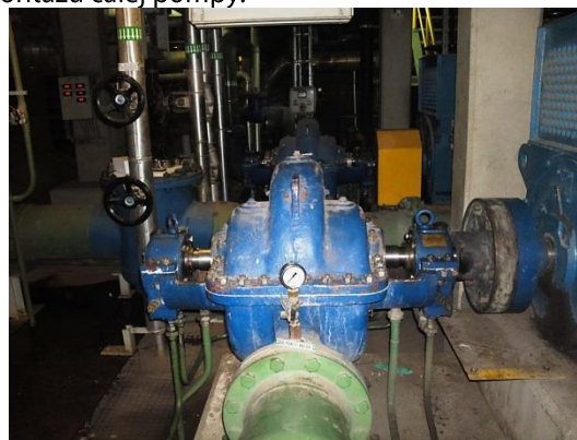
Przewałowa Pompa 25B32 w elektrowni
